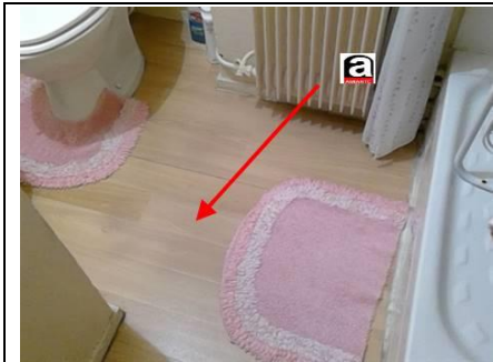
Photo n° PhA001 Localisation : Salle de bains Ouvrage : 5 - Planchers et planchers techniques - Revêtements de sols Partie d'ouvrage : Dalle de sol Description : Dalle de sol
